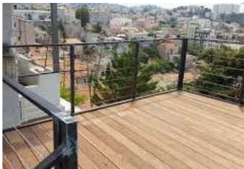
Garde-corps à câbles
