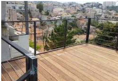
Garde-corps à câbles
